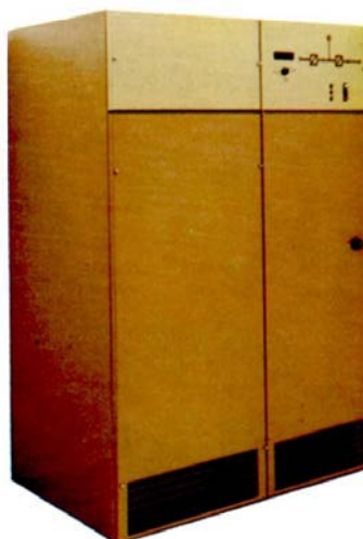
Alpac : armoire + batterie + coffret
