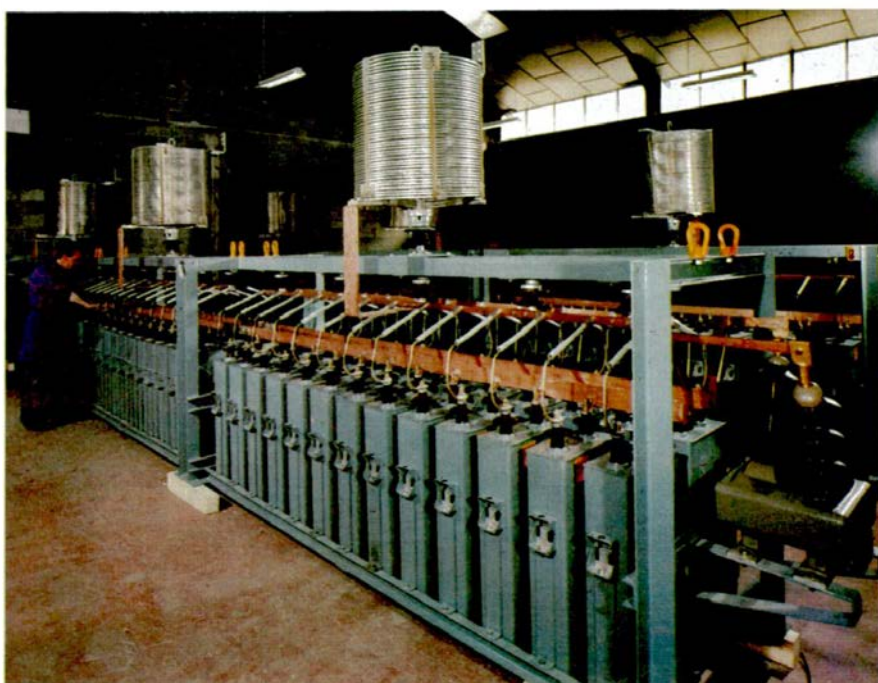
Batterie haute tension
