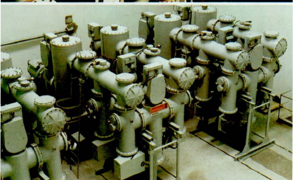
4 Charbonnages de France - Poste de Westhoulk Hexabloc 9 - 220 kV.
