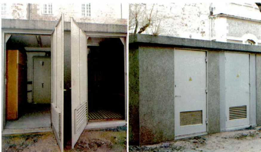
Alimentation statique en poste
