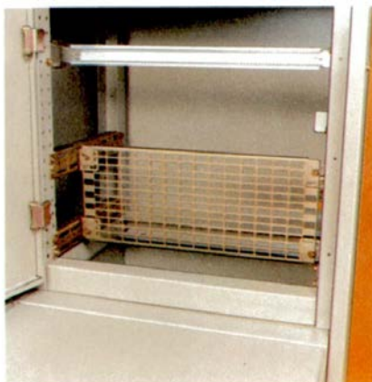
Mixage rail Multifix et plaque perforée derrière porte.
