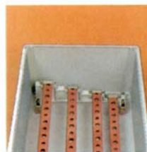
Intallation d'un jeu de barres en fond de coffret
